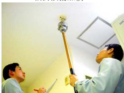
消防設備点検
