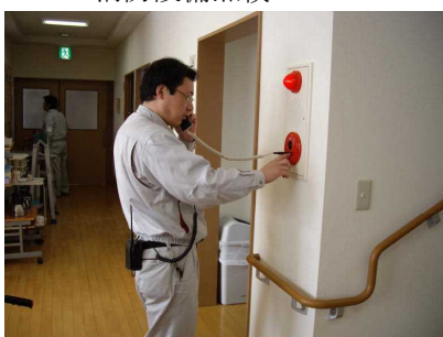
消防設備点検 2
